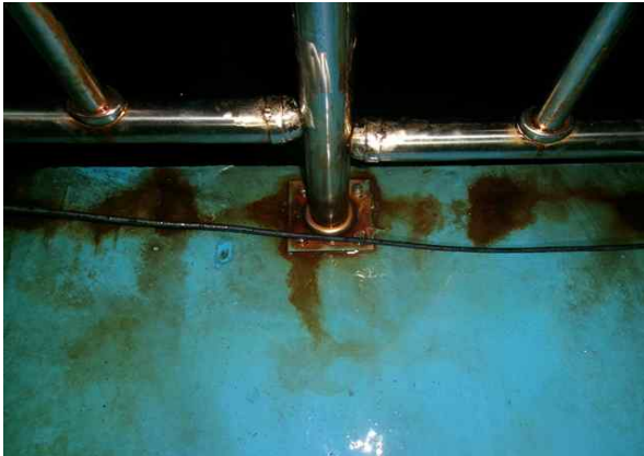
손상내용 1지 계단 녹물 손상원인 공용열화
