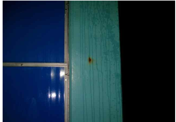
손상내용 1지 기둥 녹물 손상원인 피복부족
