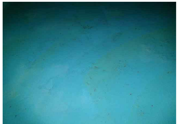
손상내용 1지 바닥슬래브 도장손상 손상원인 공용열화
