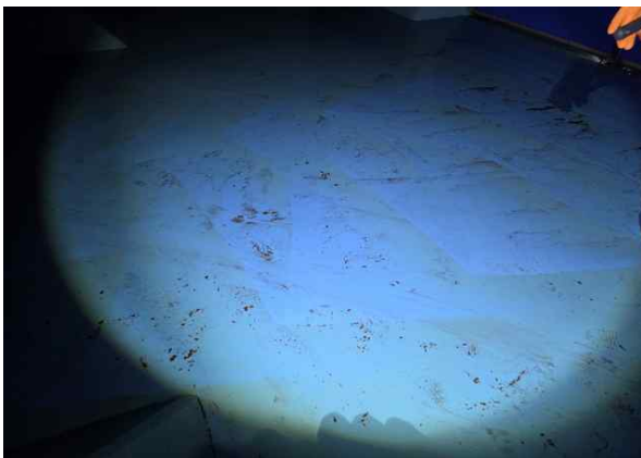
손상내용 1지 바닥슬래브 도장손상 손상원인 공용열화
